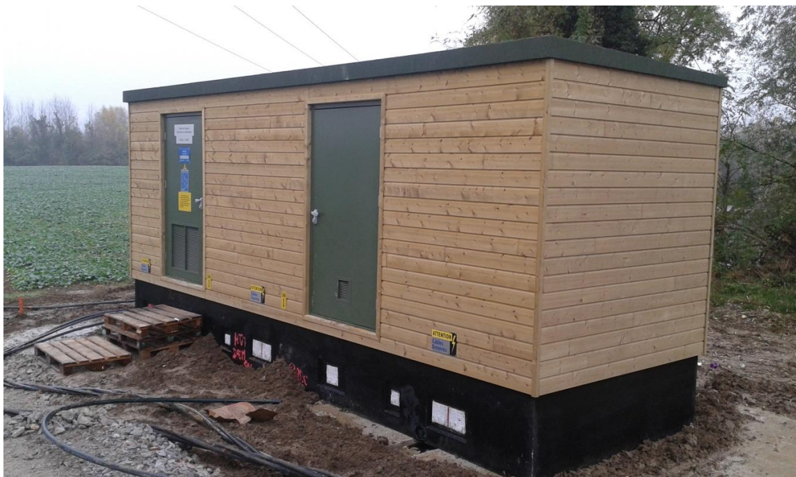
Figure 20 : Le modèle de poste de livraison retenu
